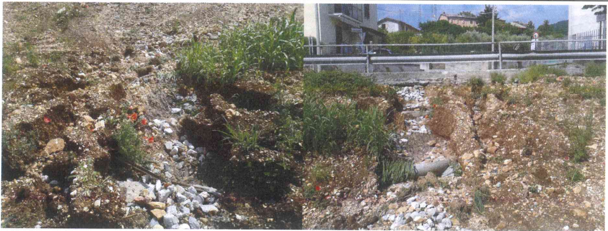
Fig. 4: solchi erosivi dovuti alle acque scaricate dalla strada che si dirama verso est (proseguimento di via monte Cucco)
